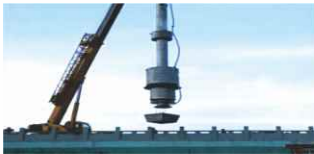
扬水曝气系统水质优化项目
